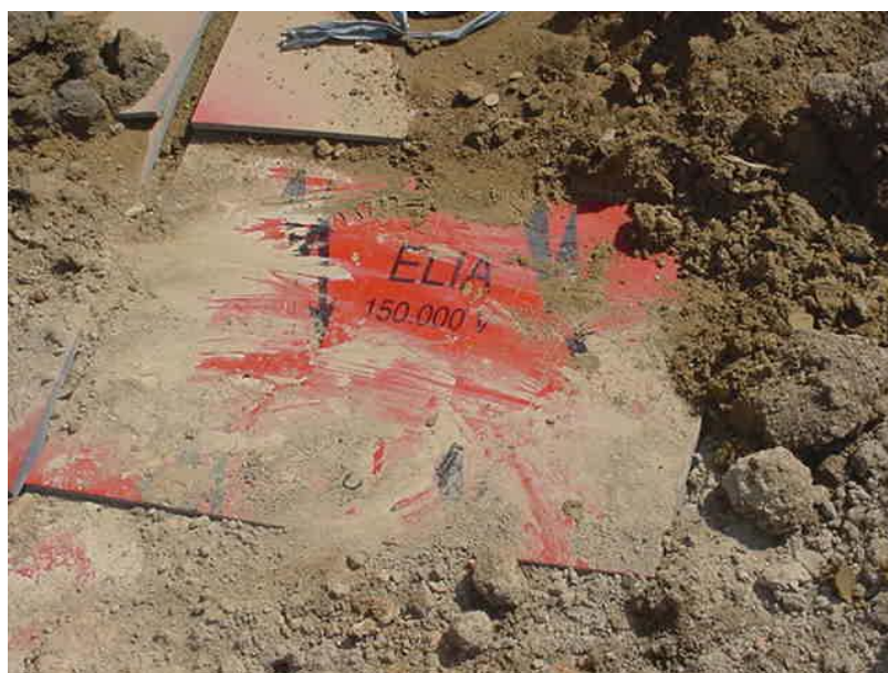
Figuur 23: Afdekken van hoogspanningskabel met kunststofplaten
