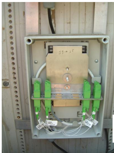
Figuur 18: Afgewerkte glasvezelkabel (FO) voor temperatuurmeting
