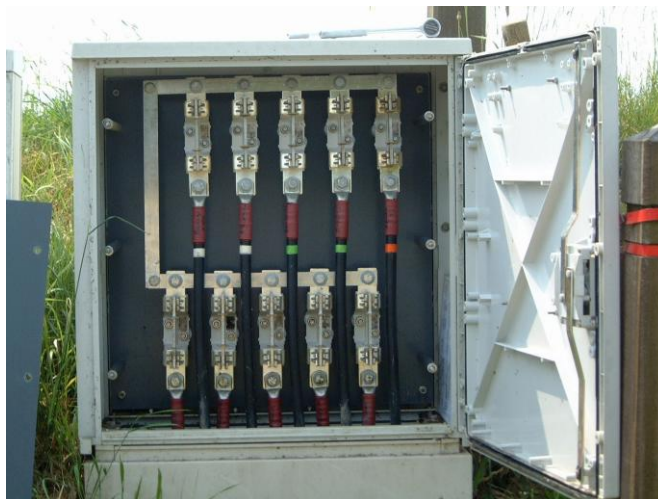
Figuur 17: Voorbeeld van een verbindingkast met onderbreking van de schermen
