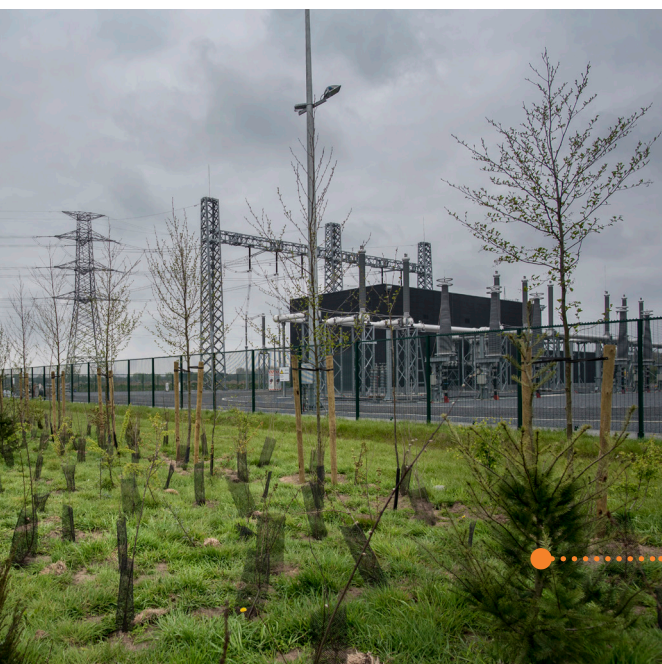
Voorbeeld van aanplanting groenschermband bij een nieuw hoogspanningsstation.
