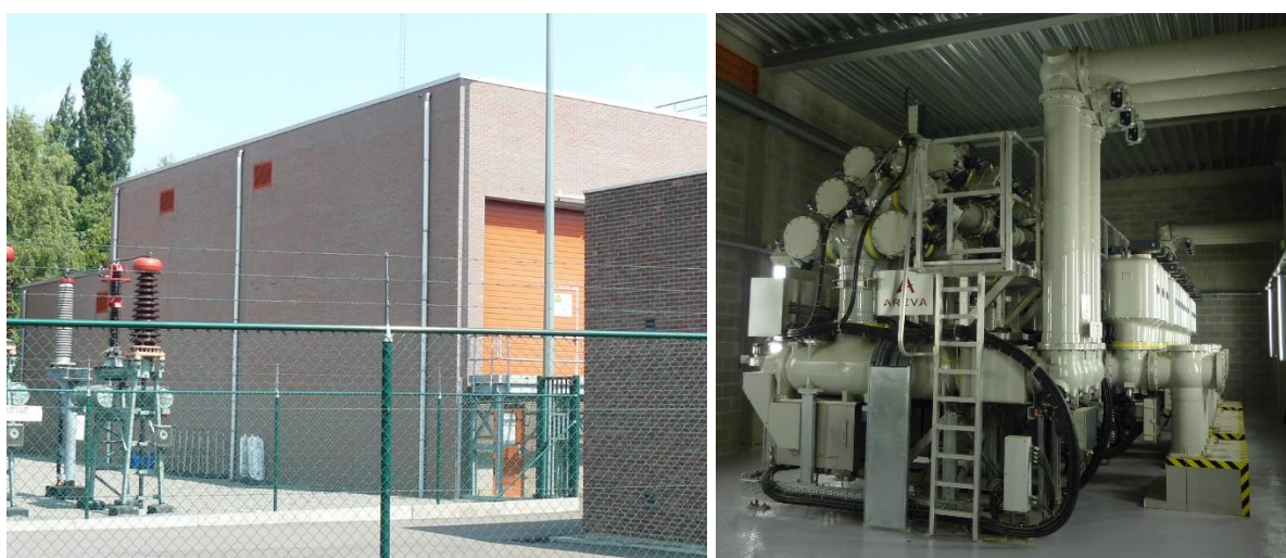
Figuur 1.5: 150 kV onderstation van het type GIS
