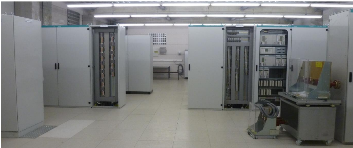
Figuur 1.6: secundaire uitrustingen van een onderstation
