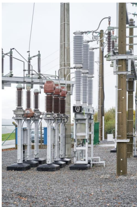
Figuur 2.6: Eerste SF6-vrije vermogensschakelaar van een nieuwe generatie op Elia-net op 70kV (Onderstation van Marcourt 70kV)
