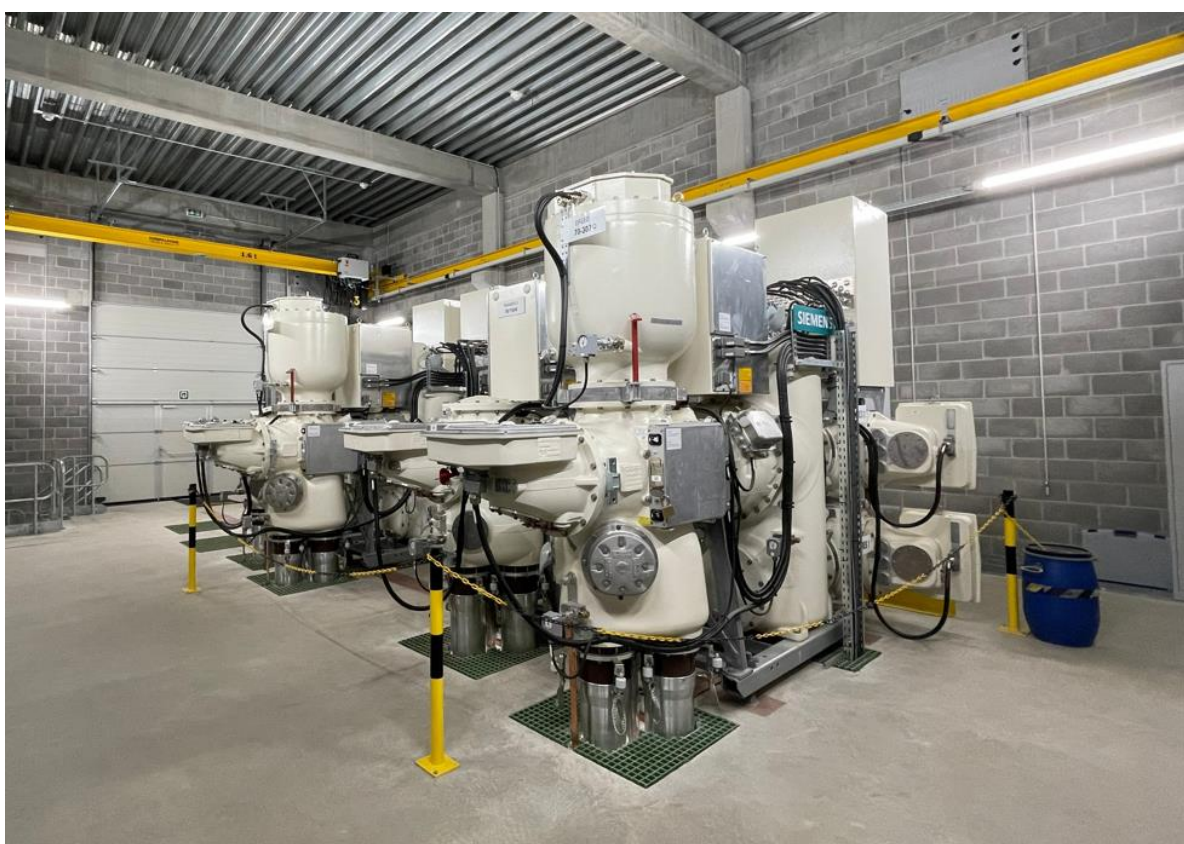
Figure 2.2 Sous-station GIS de Fays-les-Veneurs (sous-station 70 kV en gabarit 110 kV)
