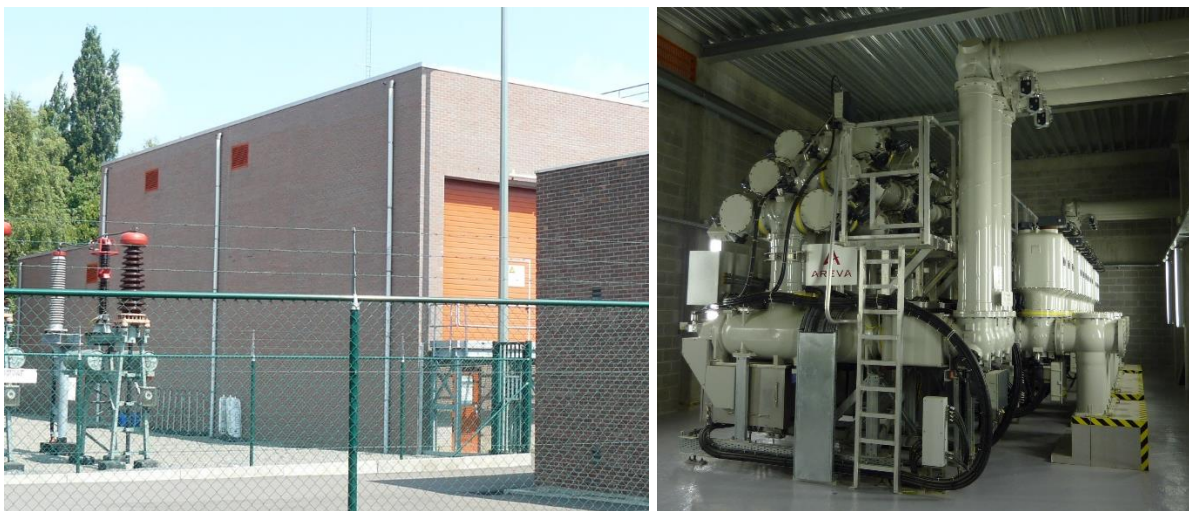
Figuur 1.5: 150 kV onderstation van het type GIS
