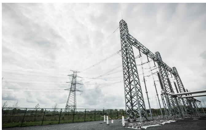
Elektriciteitsverbinding die vertrekt vanuit hoogspanningsstation
