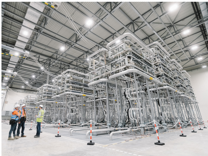
Binnenkant van een conversiestation
