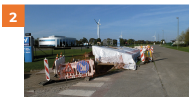
2 Le puits de jonction d'un câble de 70 kV.
