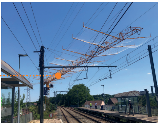
Exemple de liaison aérienne qui longe un chemin de fer.
