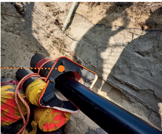
Gaines d'attente pour une double liaison de 150 kV.
