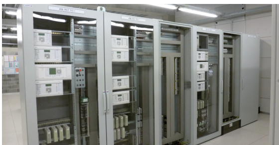
Controleruimte van een 380kV-hoogspanningsstation
