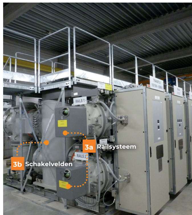
Binnenkant GIS-gebouw met schakelapparatuur
