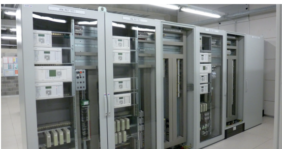
Controleruimte van een 380kV-hoogspanningsstation
