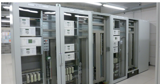
Controleruimte van een 380kV-hoogspanningsstation
