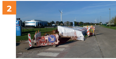
2 De mofput van een 70kV-kabel.
