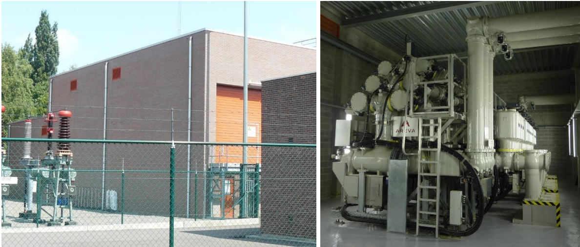
Figuur 1.5: 150 kV onderstation van het type GIS
