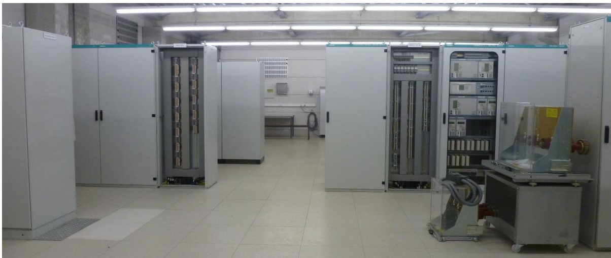
Figuur 1.6: secundaire uitrustingen van een onderstation
