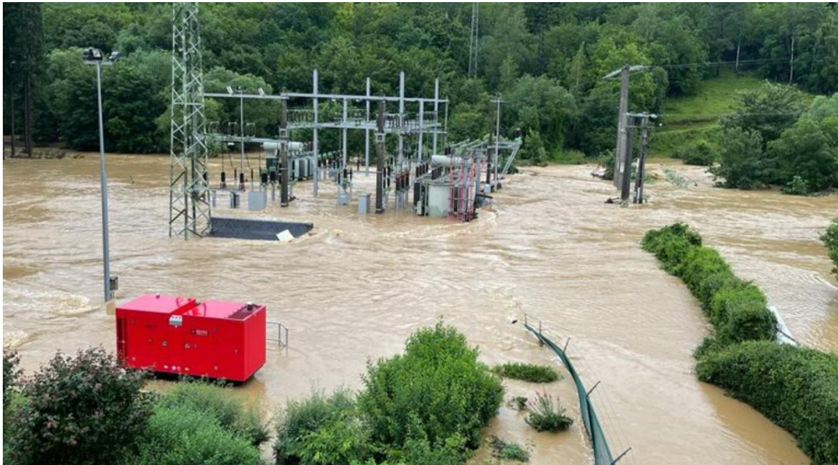
Figuur 2.9 : Overstroming van een hoogspanningspost ten gevolge van de extreme regenval in juli 2021
