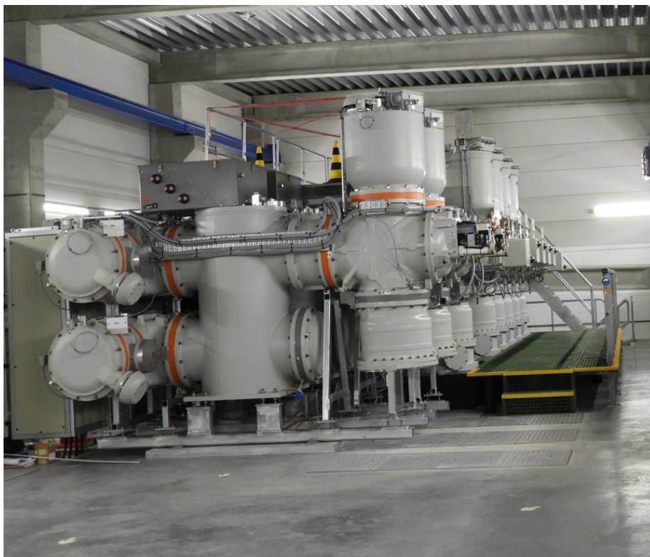
Figuur 2.5 : uitbreiding GIS onderstation van Ieper
