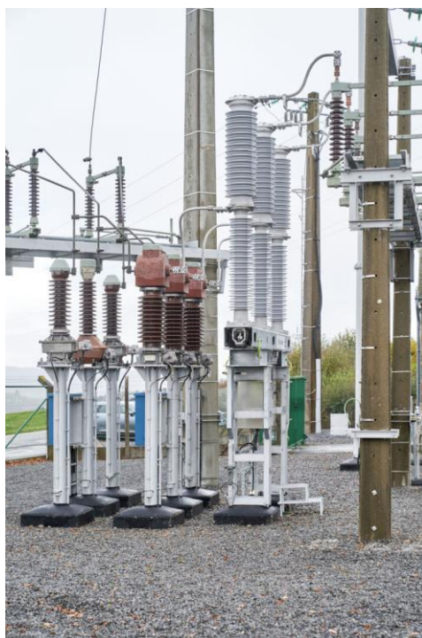
Figuur 2.7 : Eerste SF 6 -vrije vermogensschakelaar van een nieuwe generatie op Elia-net op 70kV (Onderstation van Marcourt 70kV)
