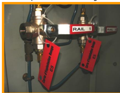
Ontluchten van pneumatische kring
